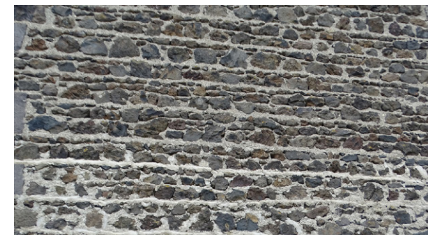
Mur en scories volcaniques rejointoyé
