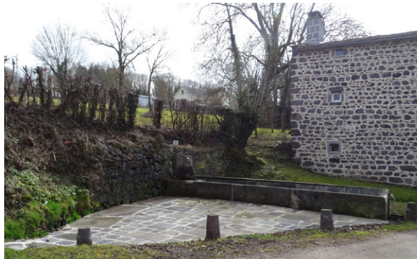
La fontaine abreuvoir de Bravant, récemment rénové suite à un chantier participatif d'habitants
